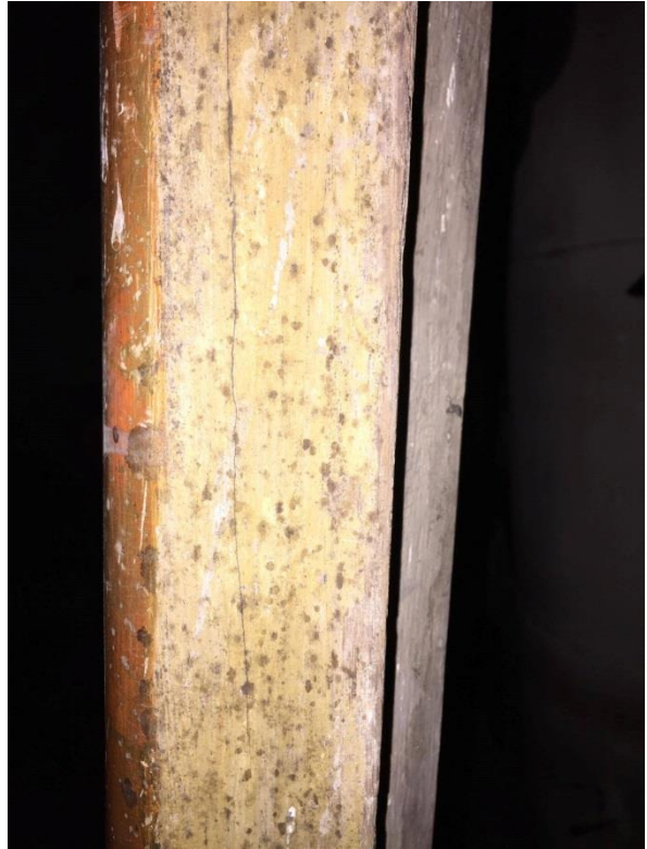
Détail : traces d'éclaboussures sombres et de moisissures clairsemées.
