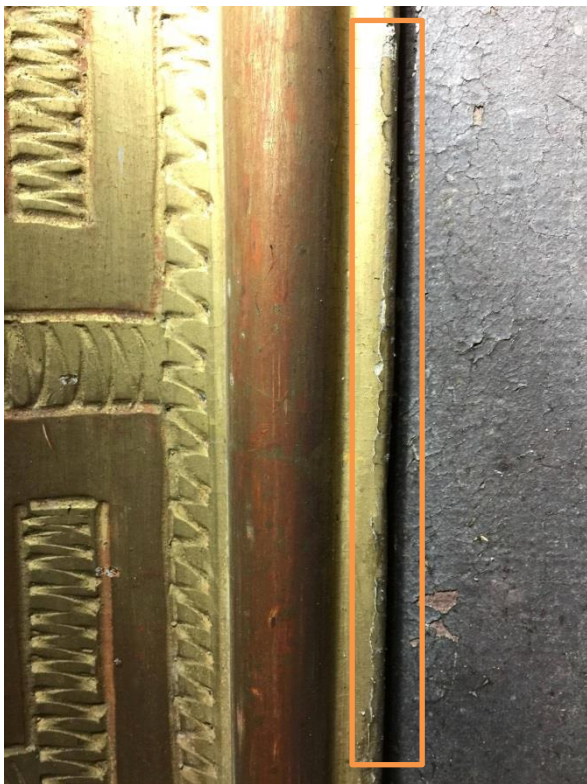
Détail : côté gauche avec fissure de la vue et éclats parcourant le cadre.
